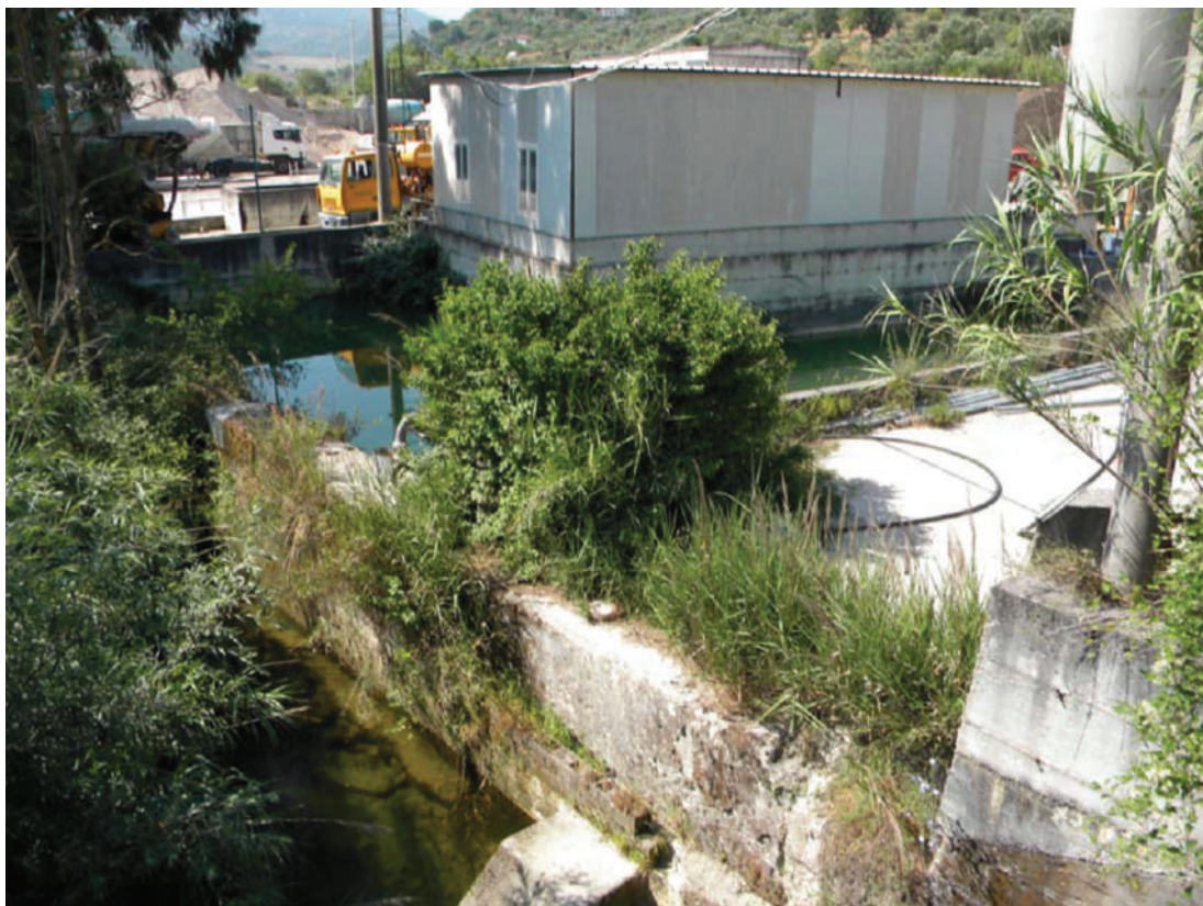
Foto 1 – Alveo ristretto da muri in cls che ne riducono fortemente la sezione. Sulla destra dell’alveo fluviale è visibile un ristagno d’acqua dovuto allo straripamento del torrente.
