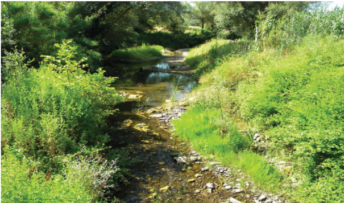
Foto 3 – Alveo invaso dalla vegetazione e forte accumulo di alluvioni a fondo alveo ed in prossimità delle sponde. Da notare la forte ostruzione della sezione
