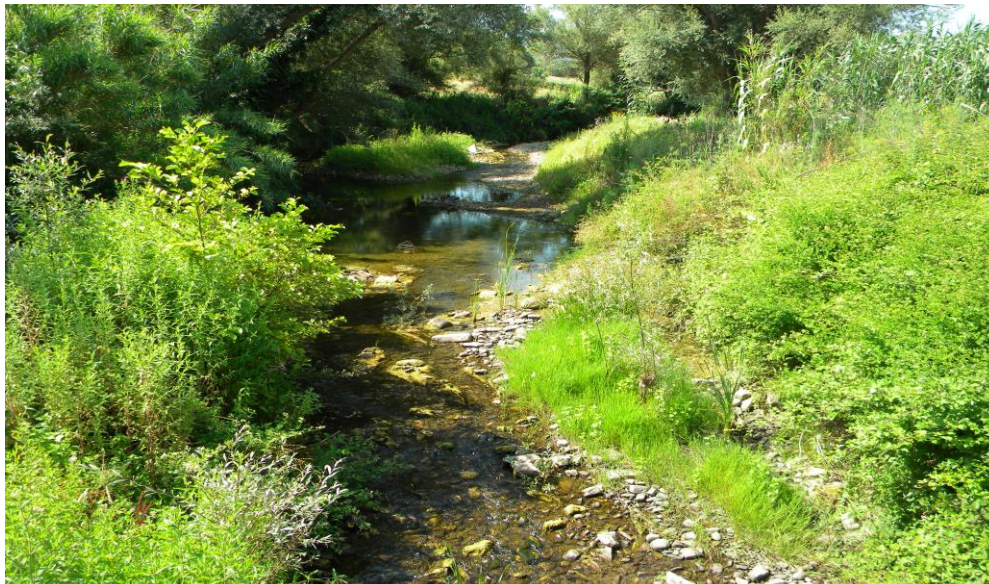
Figura 6: Alveo invaso dalla vegetazione e forte accumulo di alluvioni a fondo alveo ed in prossimità delle sponde, con sensibile ostruzione della sezione
