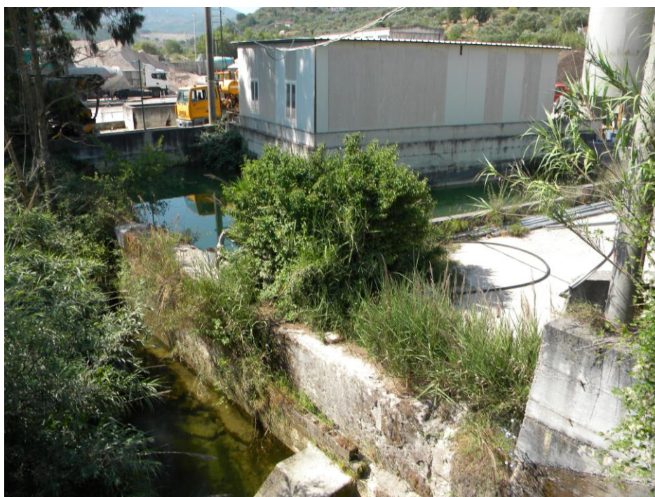
Figura 7: Alveo ristretto da muri in cls che ne riducono fortemente la sezione.
