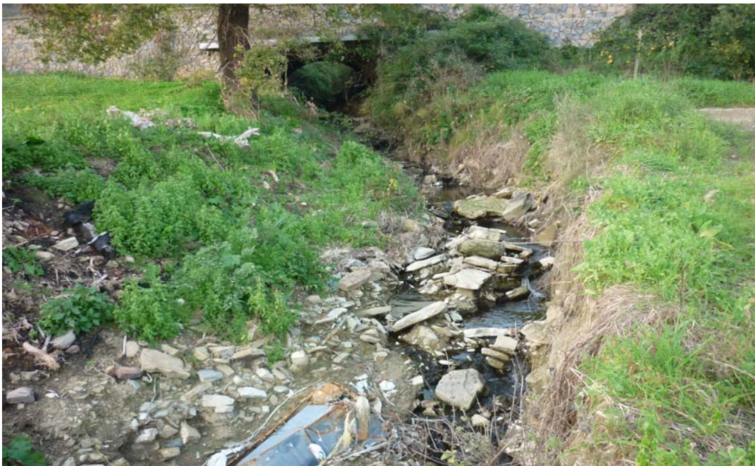
Foto 4 – Si osserva una scarsa attività erosiva sia lungo le sponde che sul fondo alveo e modesto approfondimento dello stesso che non giustifica eventuali criticità legate a fenomeni di dissesto lungo le aree spondali.
