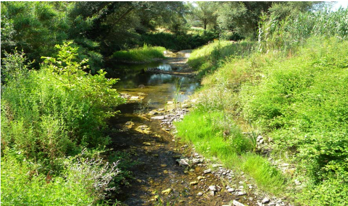
Foto 3 – Alveo invaso dalla vegetazione e forte accumulo di alluvioni a fondo alveo ed in prossimità delle sponde. Da notare la forte ostruzione della sezione
