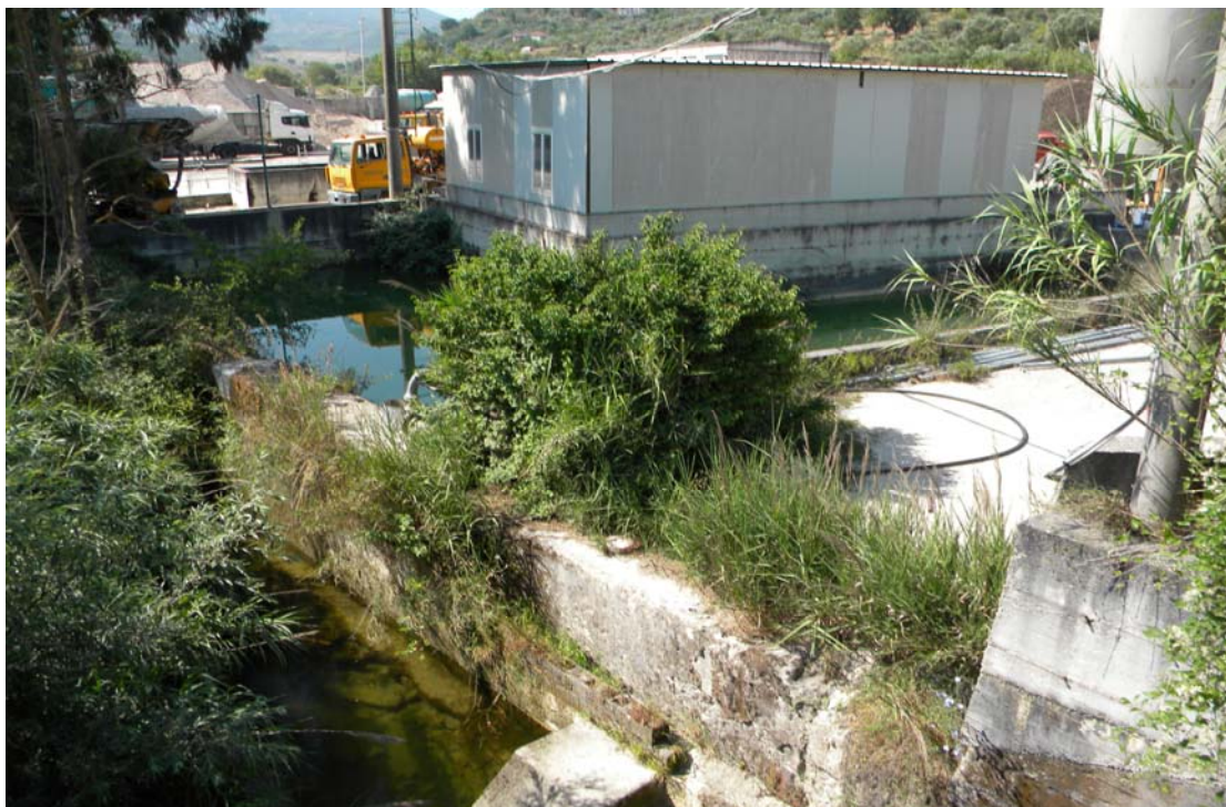
Foto 1 – Alveo ristretto da muri in cls che ne riducono fortemente la sezione. Sulla destra dell’alveo fluviale è visibile un ristagno d’acqua dovuto allo straripamento del torrente.
